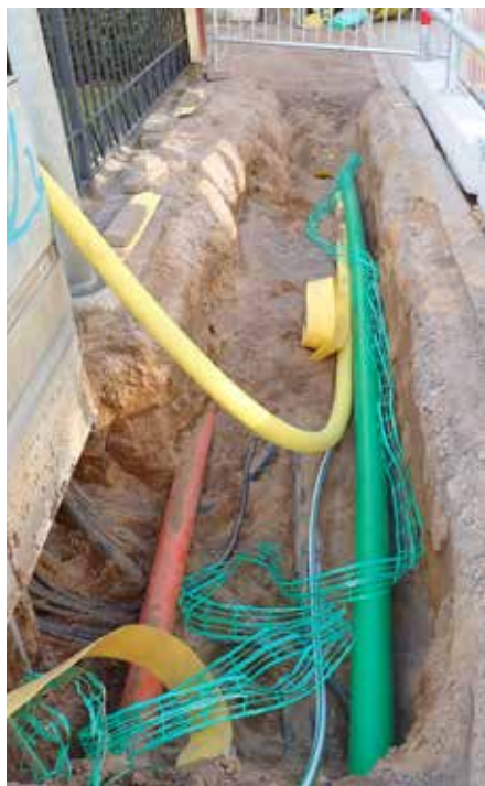
Figur 4. Diversa kabelledningar i schakt 1. Foto från nordöst.
