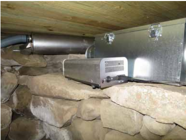
Till avfuktarens utluftsdel kopplades en ljuddämpare vilken ses längst bort i bilden. Närmast en luftrenare med ozon som vid slutbesiktningen rekommenderades att slopas.
