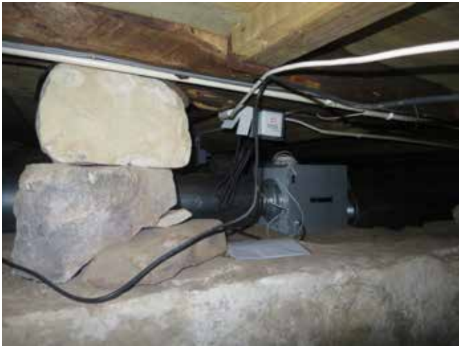
Sorptionsavfuktaren i långhusets kryppgrund.
