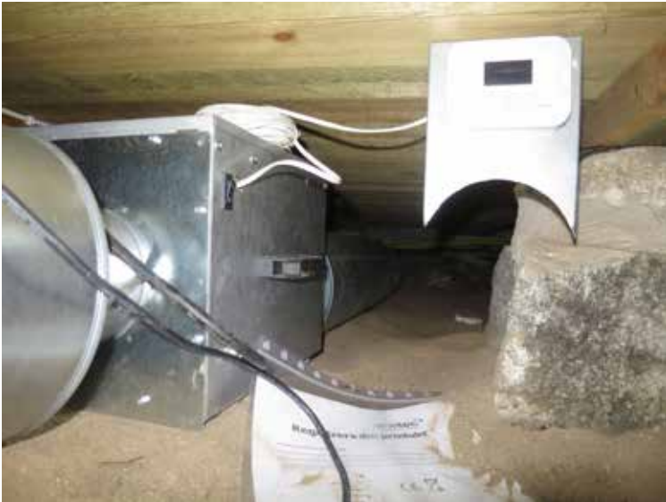
Avfuktaren i sakristians krypgrund med anslutande rör, elkablar och display.
