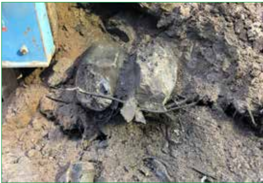
Figur 45. De dubbla grundstockarna som sticker ut i schaktkanten inom tomt 126. Foto från norr.
