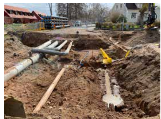
Figur 3. Projektstarten vid korsningen Västra Ågatan/Rådmansgatan med befintliga ledningar. Foto taget från N.
