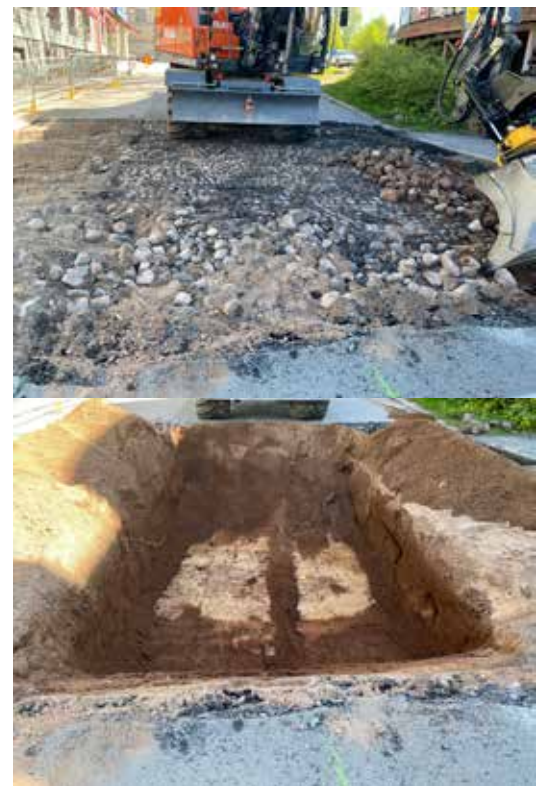
Figur 14 och 15. Kullerstensbeläggnen precis under dagens asfalt, samt botten av schaktet med naturlig sand som övergår i lera. Båda fotona tagna från V
