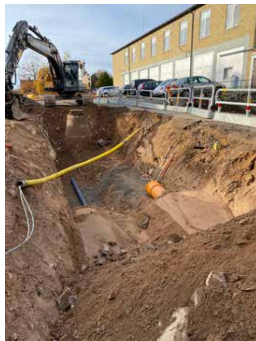
Figur 12. Schaktning i den öst-västra sträckningen av Västra Ågatan. Äldre fyllnadsmaterial syns i kanten. Foto taget från S, SÖ
