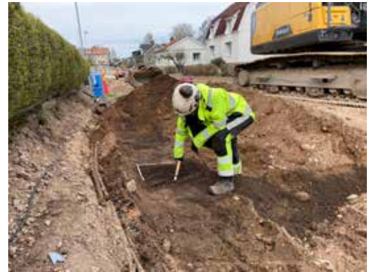
Figur 7. Kristina Jansson rensar i det framkomna kulturlagret. Elledningen syns till vänster i bild. Foto taget från S.
