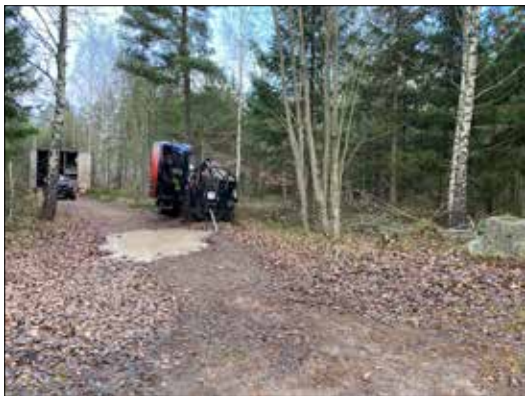
Figur 8. Borrningen av elledningen under den större vägen har börjat i den norra änden. Foto från söder.
