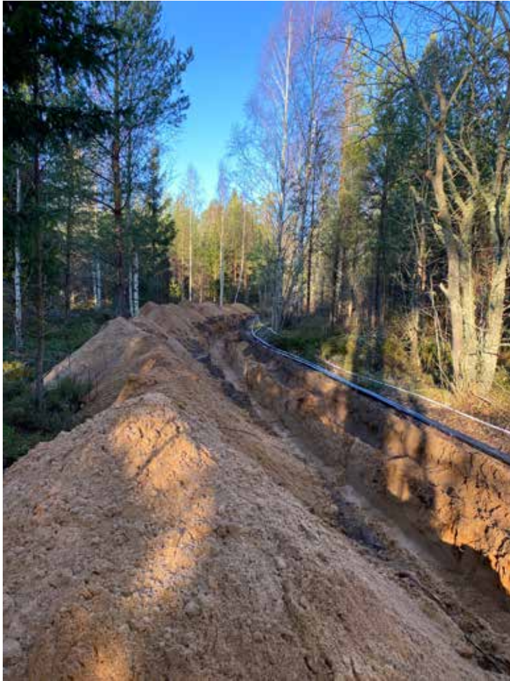
Figur 6. Här syns schaktet som drogs vid undersökningen. Den sandiga undergrunden framkom på ett djup av 0,4 meter men schaktet grävdes ner till kabeldjupet 0,7 meter. Foto från söder.
