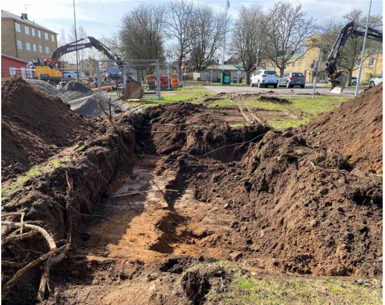
Figur 3. Schaktet där spår av odling påträffades i en smal remsa (se bilaga 1).
