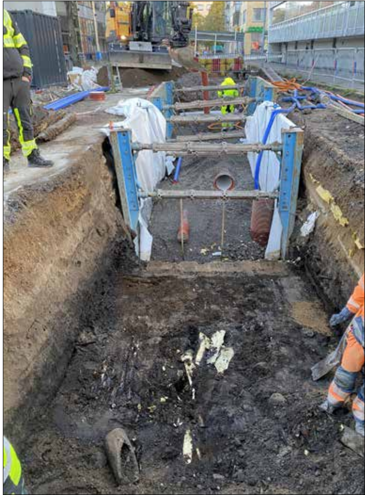
Figur 20. Översiktsbild över schaktet i Rökerigränd med den nya VA-ledningen i bakgrunden. I förgrunden ses ris och slånor i rustbädden över den naturliga torven i sektion 19. Över rustbädden låg det påförda odlingslagret. Foto från söder.
