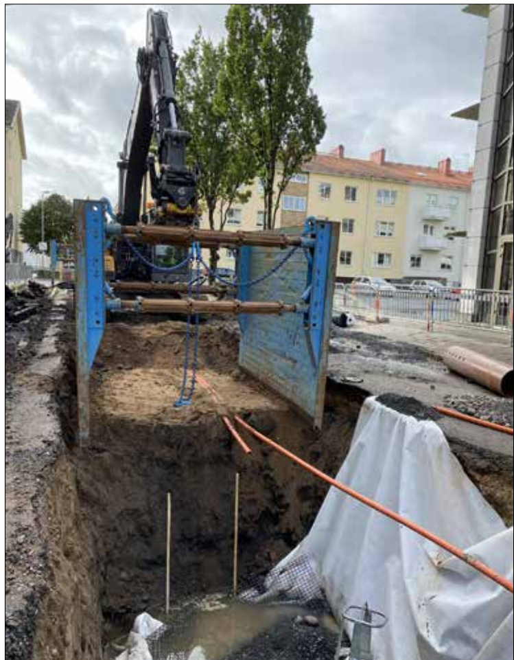
Figur 3. Exempel på användning av schaktlåda i norra delen av Rökerigränd. Foto från norr.
