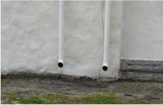
Stuprören utmed långhusets norra fasad slutar en bit upp från marken, vilket kan orsaka att vatten stänker upp på fasaden.
