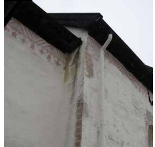
Missfärgning och visst putsbortfall i hörnet mellan långhus och kor mot norr tydde på att takets vattenavrinning inte fungerade korrekt.
