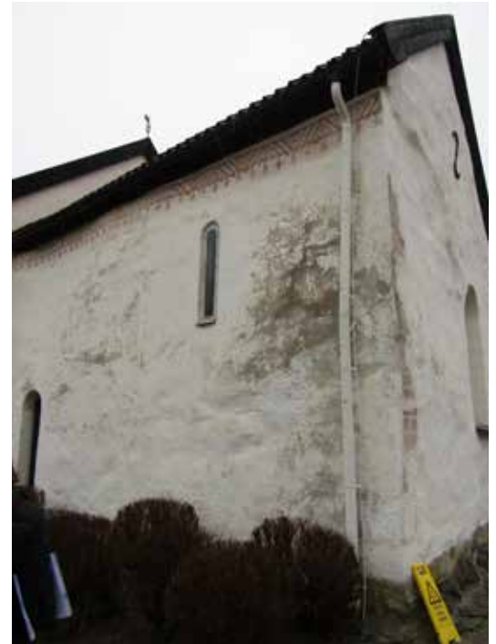
Detalj av korets sydfasad som hade omfattande algpåväxt och färgbortfall.
