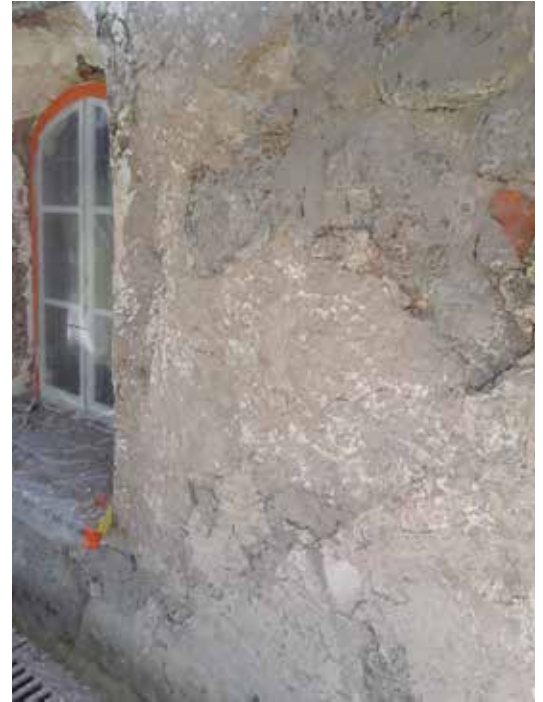
På de äldre puts-skikten väster om sakristiefönstret fanns spår av ett måleri.
