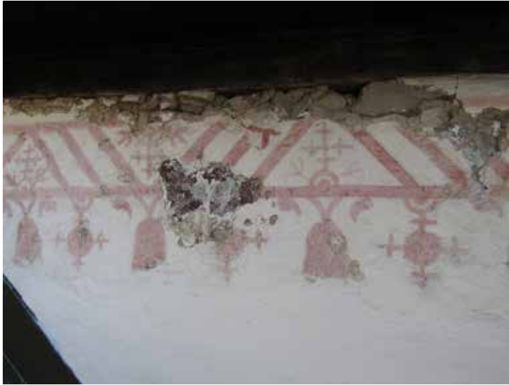
Detalj av dekorationsmåleriet vid korets norra sida, på del väster om sakristian. Här har delar av de cementförstärkta lagningarna knackats bort. Under projektets gång beslutades att låta sentida lagningar vara kvar intill takfotens måleri, för att undvika att den äldre bemålade putsen skulle skadas.
