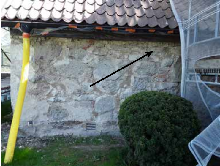
Sakristians västra fasad. Pilen markerar var det tidigare funnits en fönsteröppning. Denna sattes troligen igen på 1950-talet.
