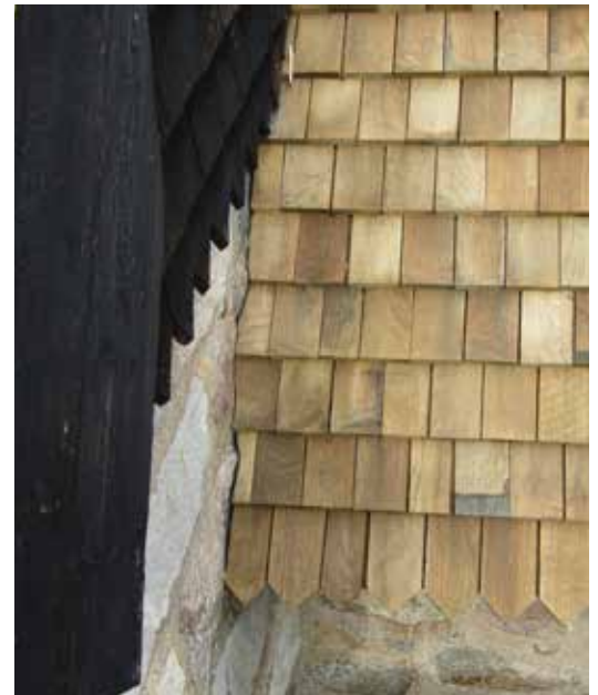
Detalj av hur korets södra takfall ansluter mot långhusgaveln. Spånen har finhuggits för hand för att anpassas mot den ojämna väggen.
