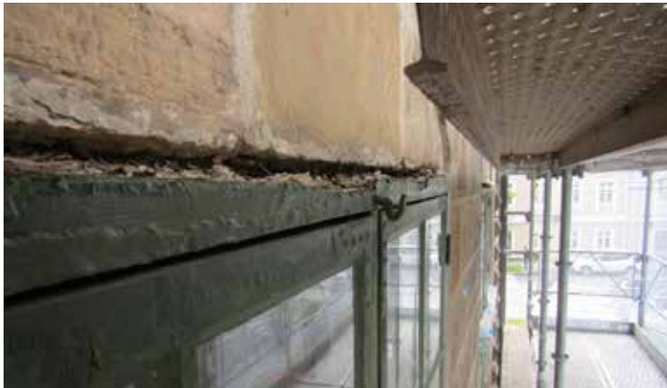
Detalj av det fönster (nr 16) som var deformerat och där dess övre del sköt ut mot fasadlivet och där rötskador uppstått.
