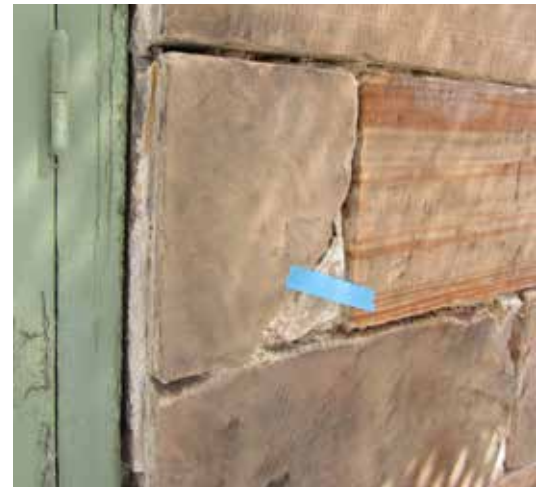
Exempel på rensade fogar och delvis skadad sten invid ett fönster (nr 5).
