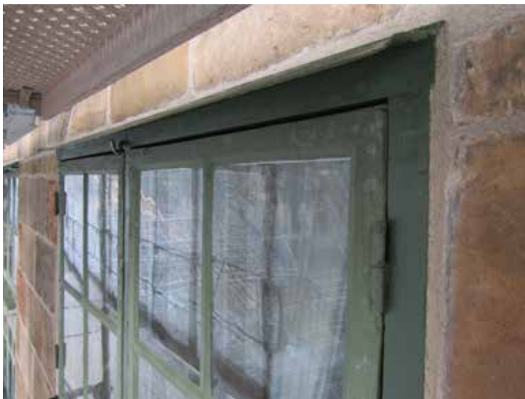
Samma fönster som ovan, men här har karmöverstycket bytts ut mot ett nytt och fästet till en tidigare markis återplacerats.
