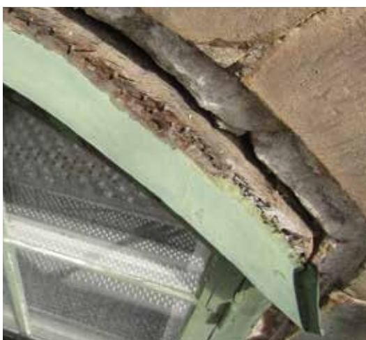
Ovan: Fönster nummer 5 och 6 har en annan kon- struktion där plåten stöter mot karmens framsida med ett uppvik. Till höger: Detta fönster (nr 4) visar den vanligaste lösningen där plåtavtäckningen ligger ovanpå karm- överstycket.
