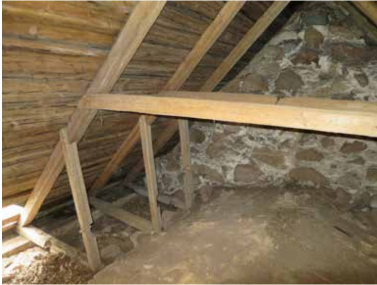
Takstolen till sakristian efter att den dragits samman och hanbjälkarna åter fästs in.
