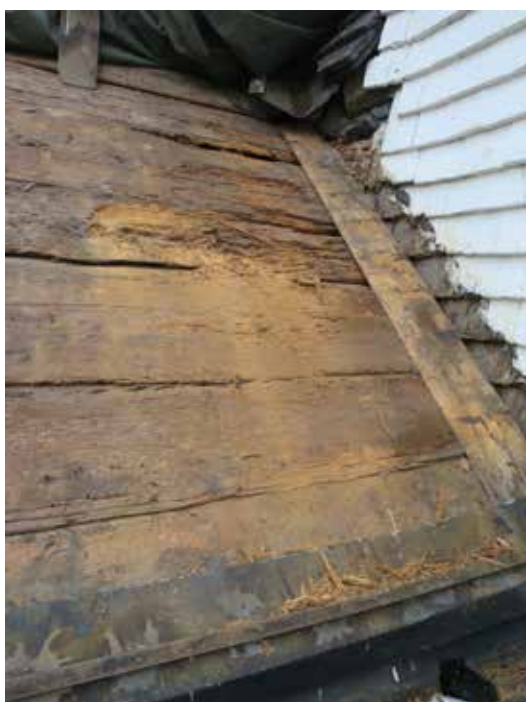
Rötskadan i taksvallen på sakristians västra takfall.
