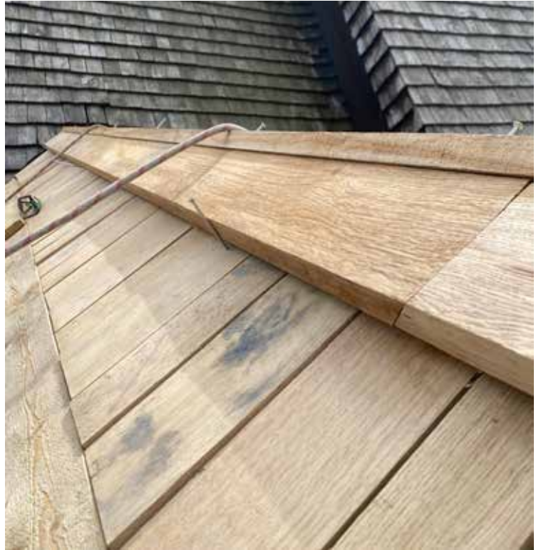
De nya nockbrädorna av ek på sakristian under montagen. De skarvades med sned kapning vid krönet (entreprenörens bild).
