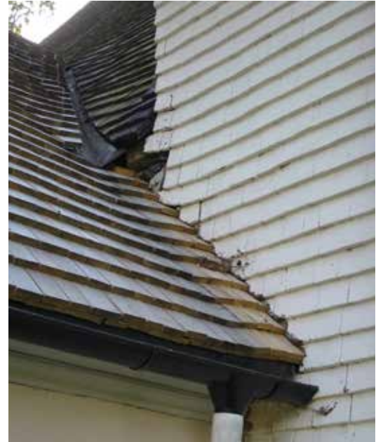
Till vänster sakristians västra takfall med sitt nya spåntak. Ovan syns spåntaketets västra rännadal och anslutningen mot långhusets fasad.
