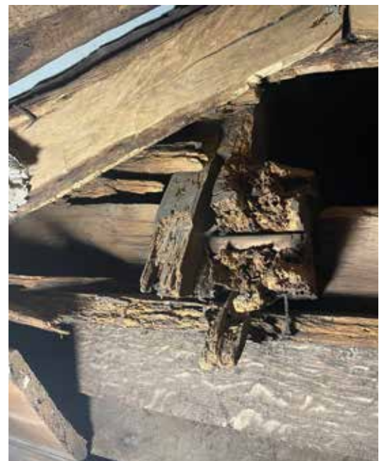
En av korets takstolar, som är synlig från sakristians vind. Denna har en kraftig rötskada i sammanfogningen mellan högben och bindbjälke som behöver hållas under uppsikt framöver.
