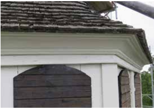
Den nedre lanterninens tak var liksom torntaket täckt med maskinkluvna furuspån från 1991.
