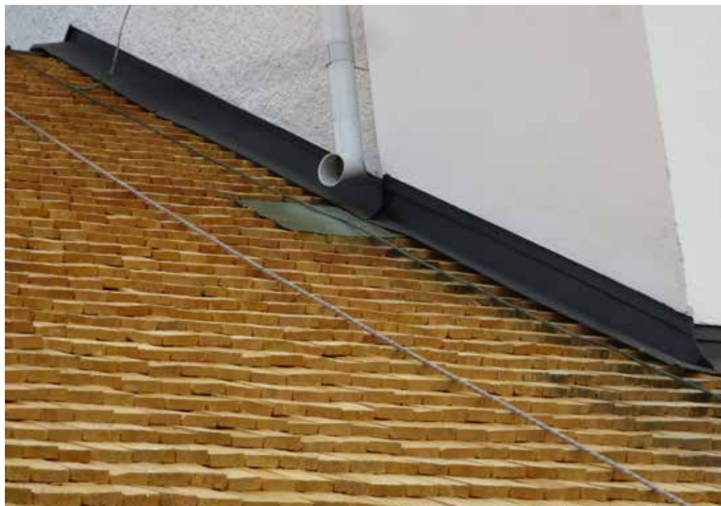
Befintlig anslutningsplåt mot tornets fasad bibehölls. Befintlig kopparplåt under stuprörsutkastaren återlades även efter spånläggningen.
