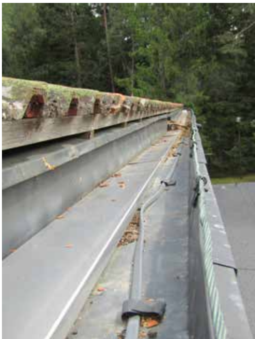
Ovan: Fotrännan med värmekabel samt tegeltakets nedre del.
