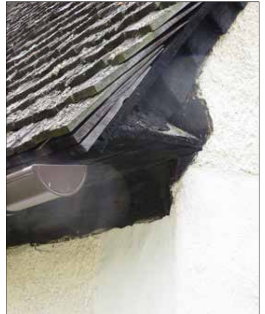
Vid sakristinas norra gavel låg spåntaket på ett litet utsprång. Vindskivor saknades. Under utsprånget låg ett skift med äldre takspån i liv med fasaden. Takfotens utskjutande brädor hade äldre "brädtak" täckta med tjärstruken papp.
