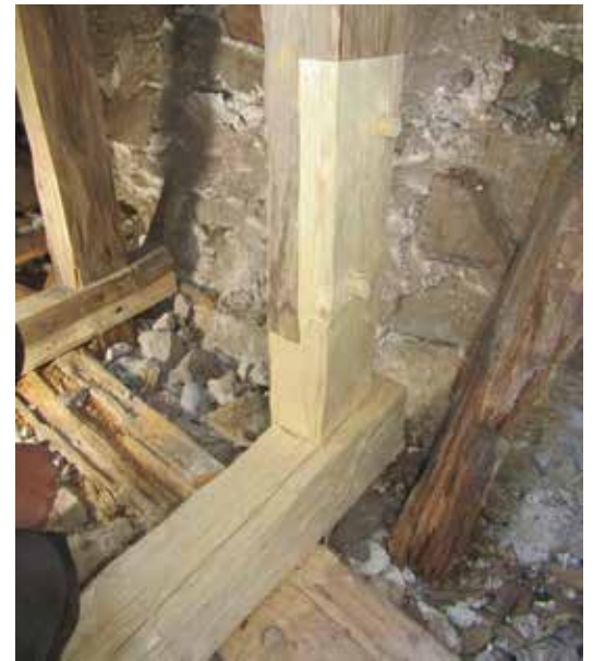
Ny tass och lagning i stödbenets nedre ände på takstol 2 åt väster.
