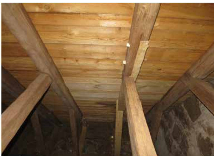
Befinlig takbottenpanel på östra takfallet efter återläggning. De ljusare brädorna är nya. De ersatte äldre rötskadade brädor. Till vänster i bilden syns även den nya hanbjälken som fick bytas i takstol 3.
