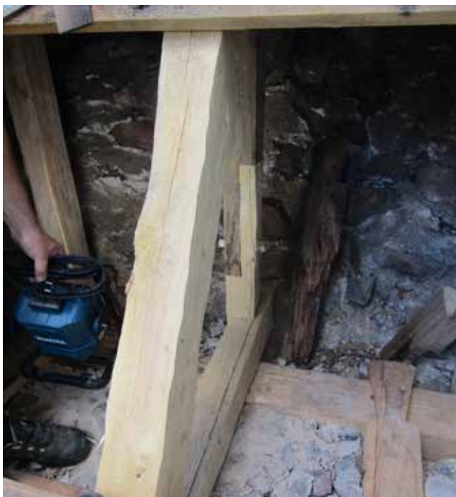
I takstol 2 byttes den nedre halvan av högbenet upp till mötet med hanbjälken samt hela tassens. Stödbetet lagades i den nedre änden.
