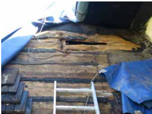
Vid en fuktutsatt punkt på sakristians västra takfall där rännaldalen slutar var takbottenpanelen kraftigt skadad av röta och insektsangrepp.
