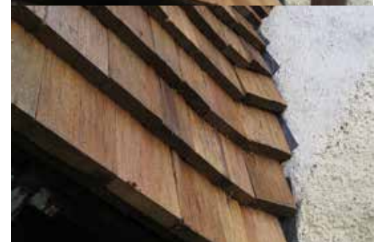
Anslutning mot fasad lades till skillnad mot tidigare med inskottsplåtar i de nedre delarna av taken. Syftet var att få till en tätare anslutning och undvika framtida täckage.
