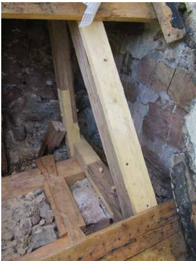
I takstol 1 gjordes lagningar av både befintlig tass och stödben. En halvsulning vidtogs på högbenets ovansida.
