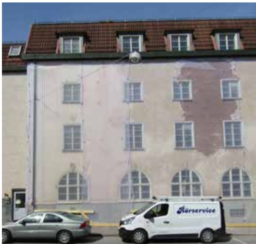
Del av den fuktskadade fasaden på Hus C. Av säkerhetsskäl var den vid besiktningstillfället klädd med nät för att förhindra nedfall av puts.
