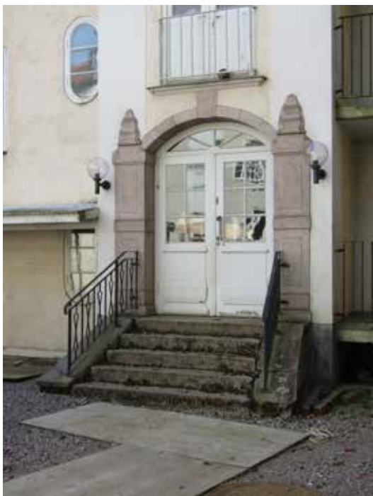
Ovan: Gårdsentrén till Hus C. Till höger: Hus C och dess skadade gårdsfasad samt påbörjad tillbyggnad mot gården. .
