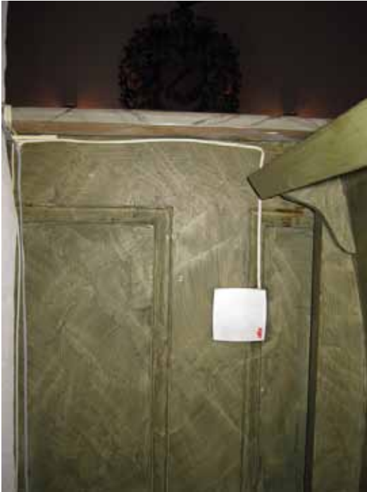
Den nya inomhusgivaren sitter i samma läge som den gamla och kabeln fram till denna är densamma som tidigare.
