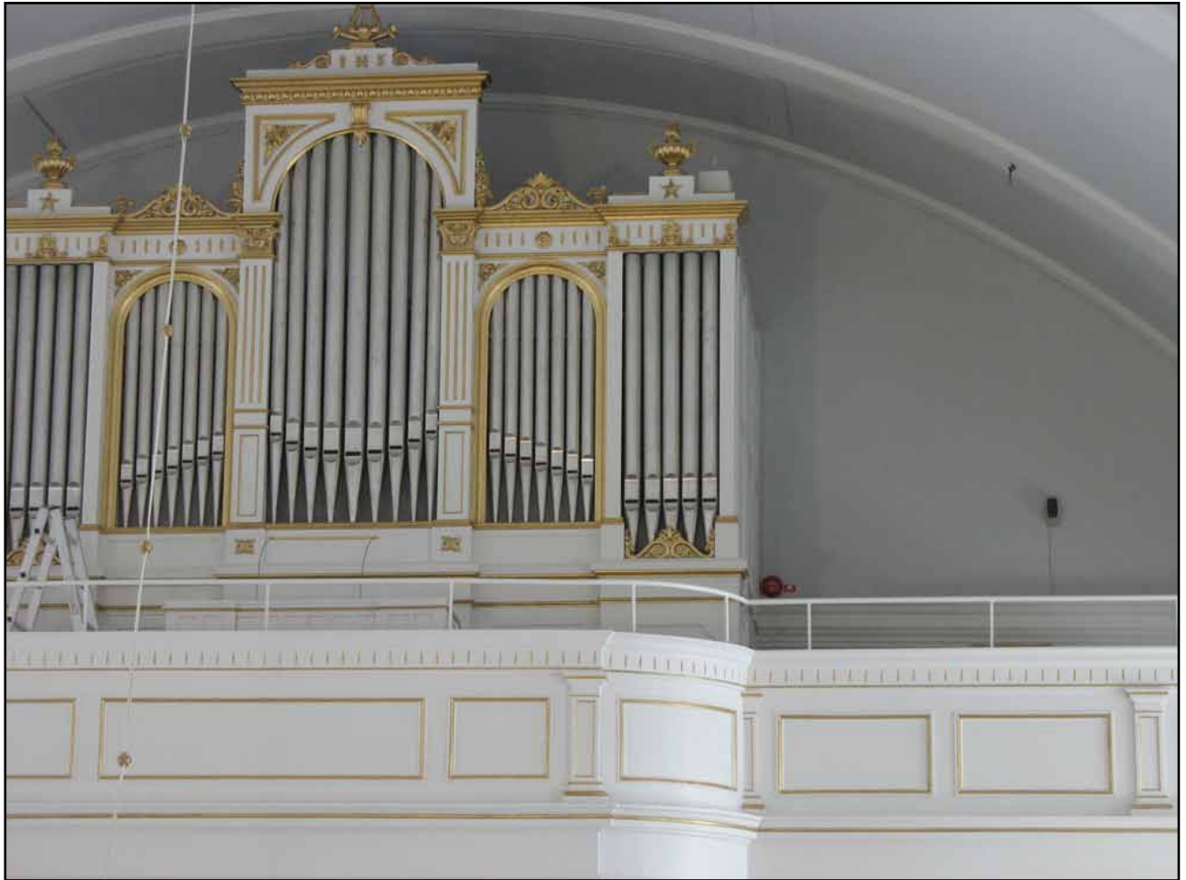
Läktaren efter ommålning och montering av skyddsräcke i smide. Till höger om orgeln ses på väggen en av de båda linjerökdetektorerna och brandlarmsklocka, ännu ej inmälad.
