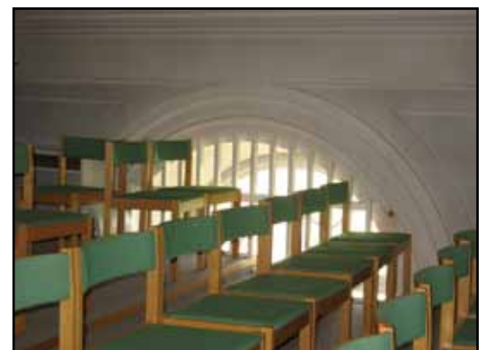
Östsidan av läktaren med feldimensionerade gradängar och spjälverk mot fönster förbundet med samlingsrummet under.
