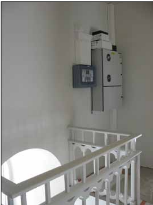
Elskåp för ny belysning och larm i tornvåning två. Om-målat räcke i ursprunglig färgsättning.
