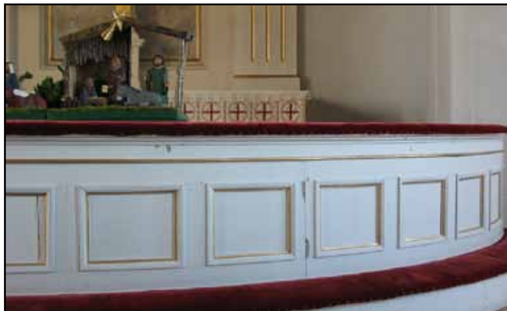
Altarringens bemålning uppvisar spjälkningar och bortfall.
