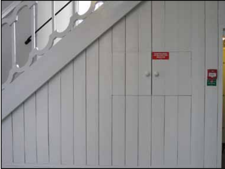
Infällt brandförvarsskåp i vapenhuset.
