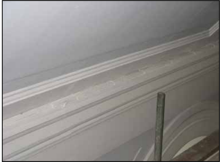
Kabeldragningar ovanpå den västra taklisten.
