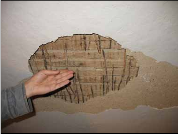
Putsskada i valv. Armering med vass.
