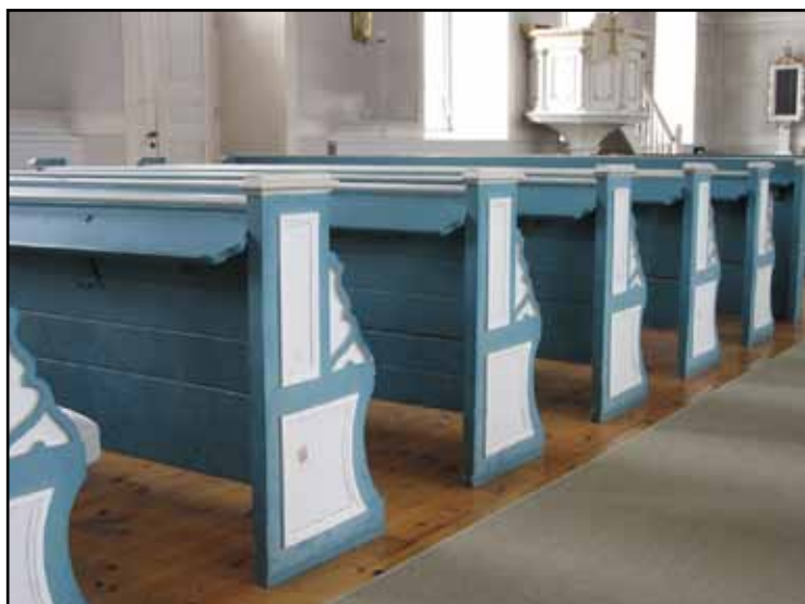
Bänkarnas färgsättning är från 1958 och är utförd i täckmålning. Torkskador.
