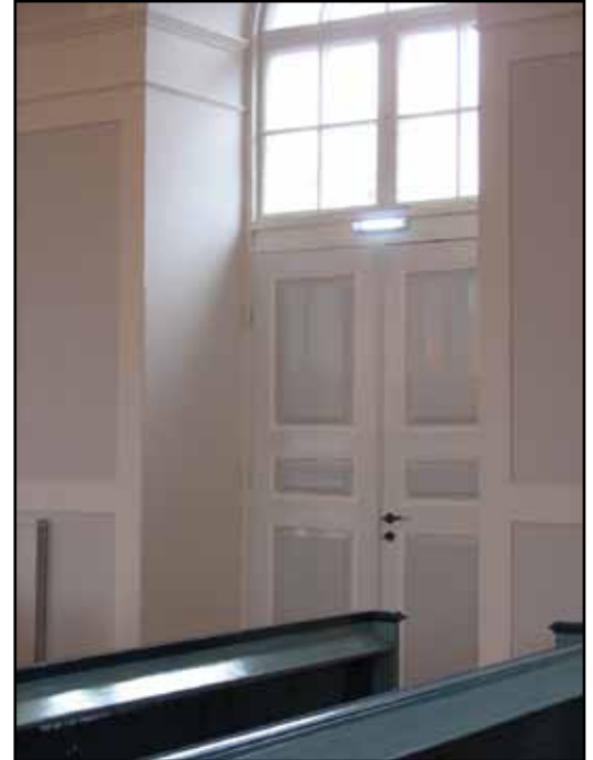
Nödljusbelysning för utrymningsväg över mittport, ett mer diskret men ändå funktionellt alternativ till gröna skyltar.
