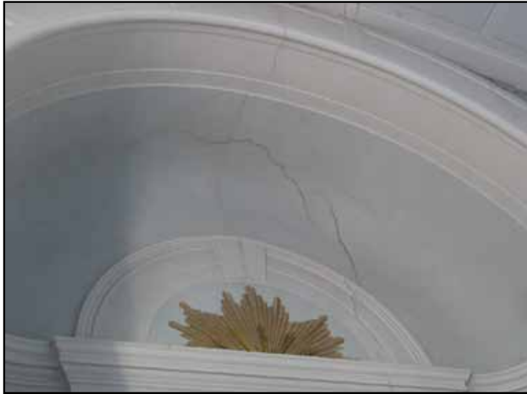
Sprickor i absidvalvet.
