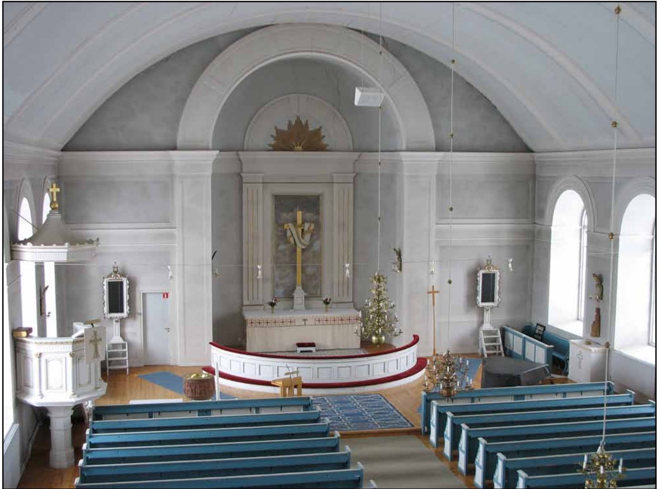
Kyrkorummet mot söder före restaurering. Väggar och valv är kraftigt nedsvärtade. Ovanför koret finns stora sprickor. En provisorisk lösning med strålkastare på ett snöre hänger över korgolvet. Koret ger överlag ett stökigt intryck.
