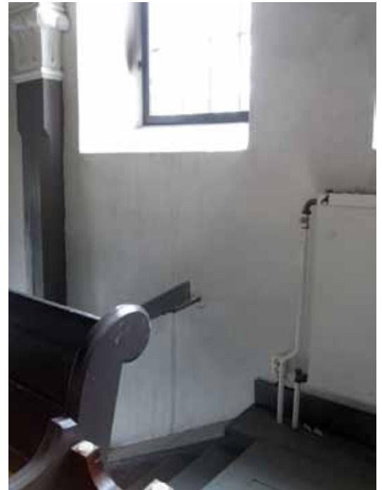
Den norra väggen med spår efter rinningar av kondensvatten.
