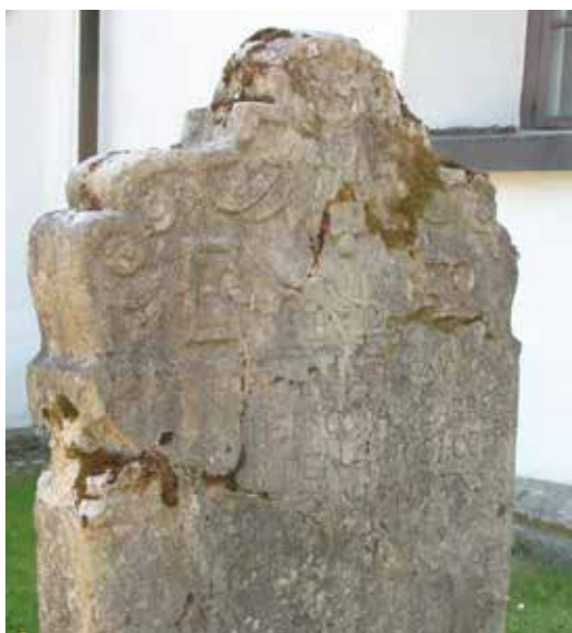
Kalksten har en förmåga att spjälka sig och spricka. Denna sten på Forserums kyrkogård i Nässjö kommun kräver insatser av en stenkonservator.
