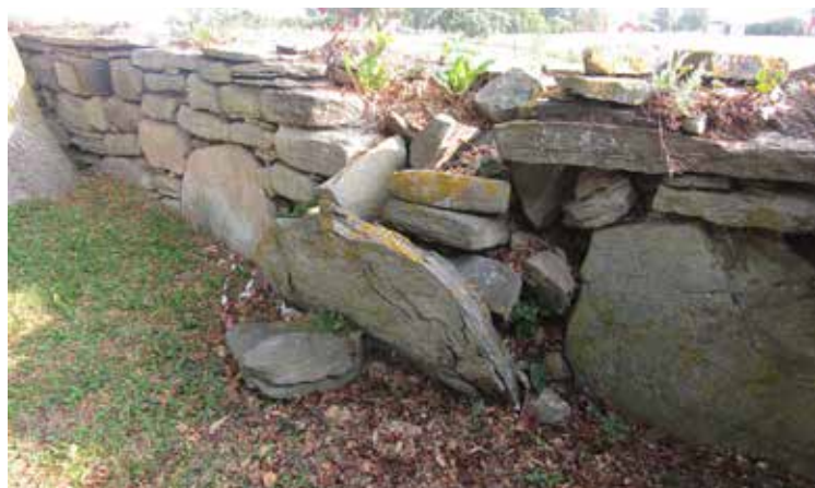
Delar av bogårdsmuren är skadad, men reparationer är planerade.
