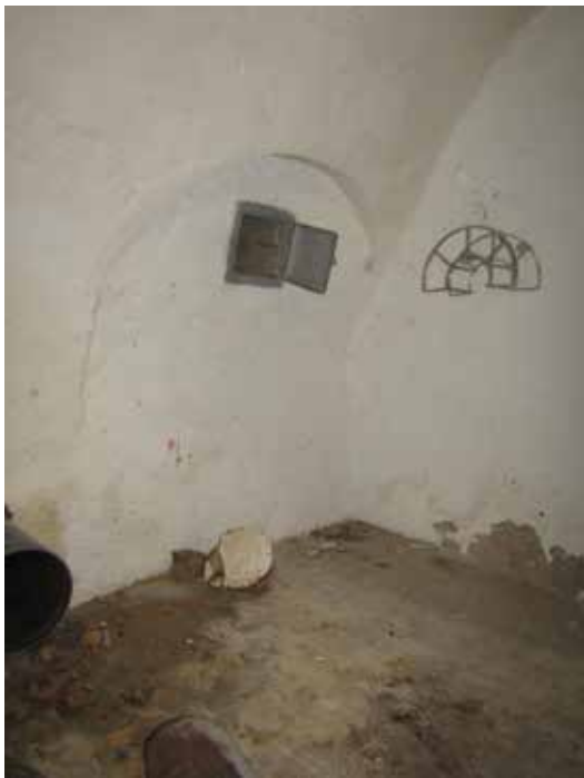
Det antydda valvet har tidigare varit öppet och vidare, men har murats igen och ersatts av en liten ventil med gjutjärnslucka. Här borrades ett hål helt nära golvet.
