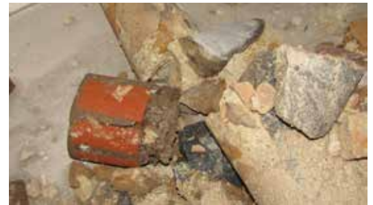
Tre exempel på uttagna borrhärnor där olika stenarter förekom. Nederst syns genomborrat tegel som härör från den påmurning från 1970-talets början när byggnaden grundförstärktes.
