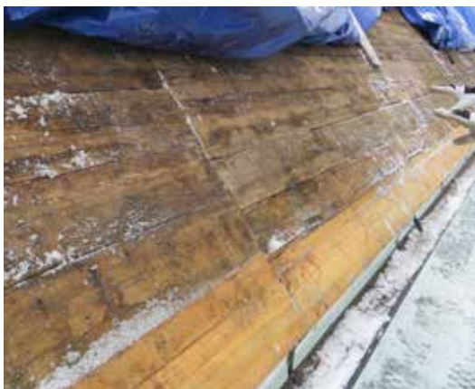
Vid takfoten hade undertakets brädor bytts ut vid den senaste spånolaggningsen.
