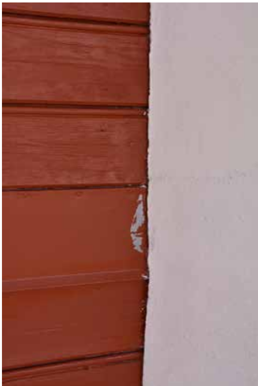
Ommålad tornlucka med en skada efter borttagen maskeringstape. Fotografi från delbesiktning från ställning den 19 augusti.
