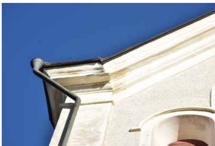
Skadorna på taklisten i anslutning till taket var troligen orsakade av ständrännornas konstruktion.
