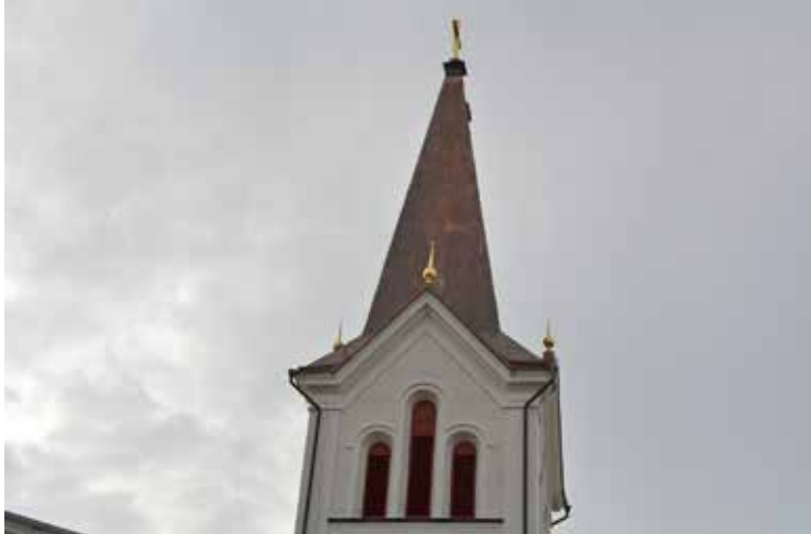
Tornet med det omtäckta taket och spiran, omförgyllda dekorationer och putslagad och avfärgad fasad.
