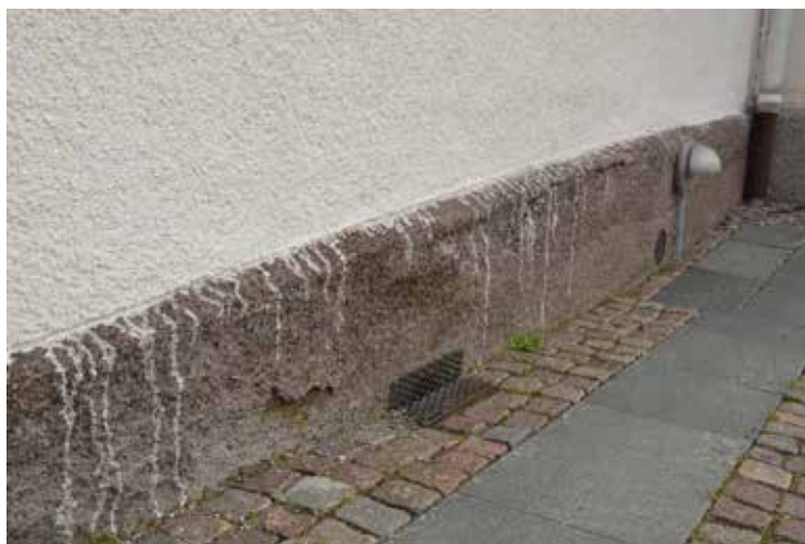
Rinningar ner på sockeln, foto från slutbesiktningen.
