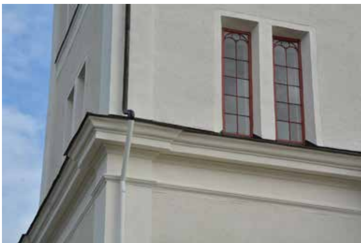
Tornet från söder, slutbesiktning. I bild kan man se mittlist med ommålad plåtavtäckning och delvis målat stuprör samt ommålade fönster.
