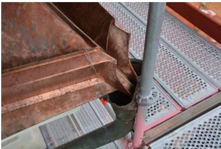
Stuprörsträtt skadad av att ställningen stod för nära.
