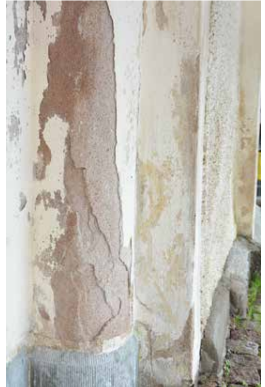
Putsskador på kalvkolonnerna vid entrén.
