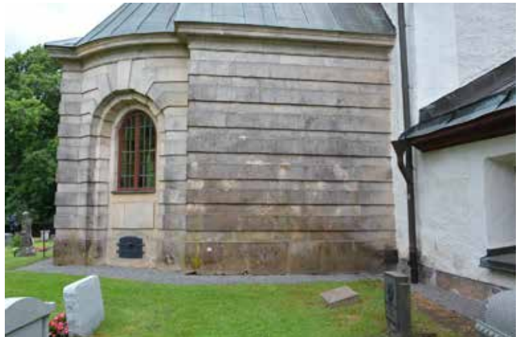
Översikt norra fasaden, flera gamla lagningar har patinerats för att inte vara lika iögonfallande.
