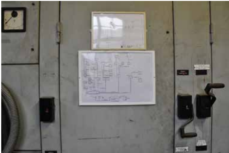
Gruppförteckning och kopplingsschema monterat på ställverket.
