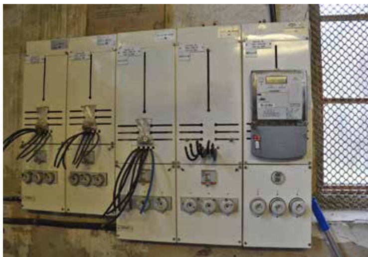
Mätartavla på väggen i huvudcentralen. När det fanns olika verksamheter i lokalerna fanns det också flera av varandra oberoende mätare, dessa är nu urkopplade och hela anläggningen går på samma mätare.
