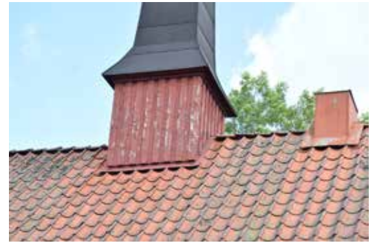
Färgen på takryttaren flagade relativt kraftigt.
