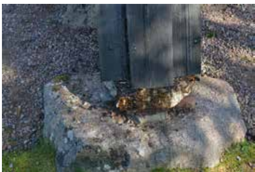
Vid slutbesiktningen noterades stänk av tjära på klockstapelns grundstenar.
