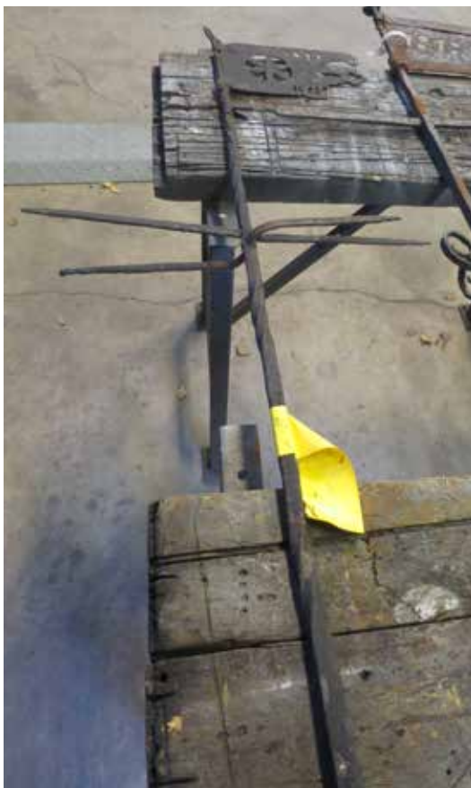
Vindflöjeln från vapenhuset. Två av vädersträckspilarna är kraftigt deformerade.
