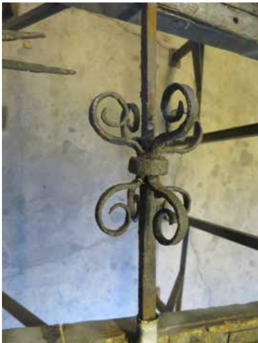
Under blysvepen till åskledarens infästning har det uppstått korrosion.
