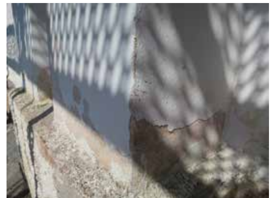
En rosagul kulör fanns under ytputsens på långskeppets fasader. Under dagens vita färgen fanns en gulvitt kulör som nu återskapades vid ommålningen.
