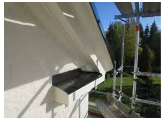
Felaktigt utförda täcklister hade orsakat putsskador i västgavelns båda gesimser. Skadorna lagades och täcklisterna byttes till nya av Kulturplåt.
