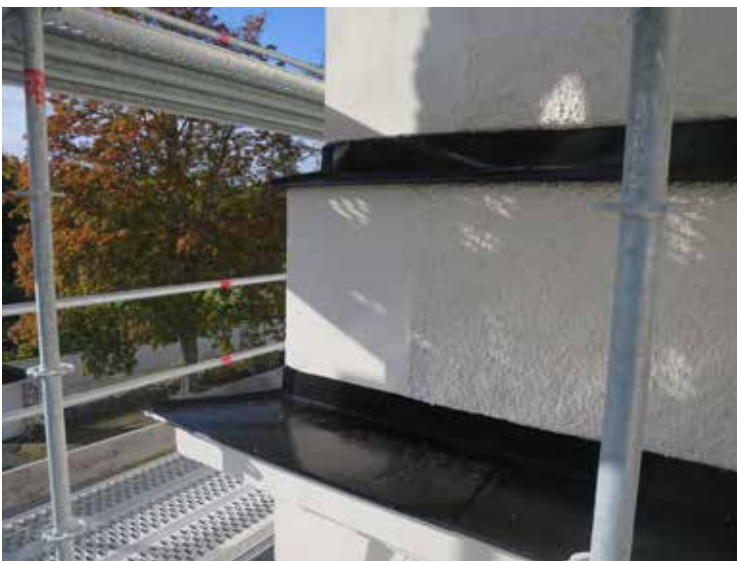
Tornfasadens dubbla gördellister där plåten målades om med svart Isotrol.
