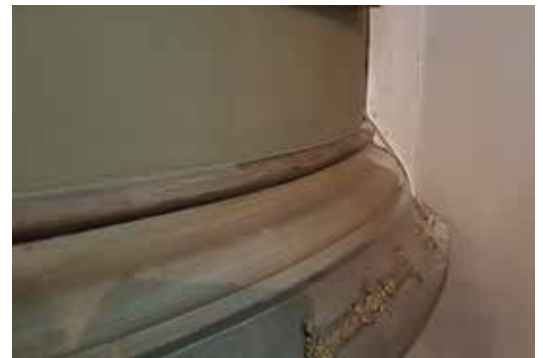
Damm på predikstolskorgen. Foto konservator Bibi Pålenäs, december 2019.
