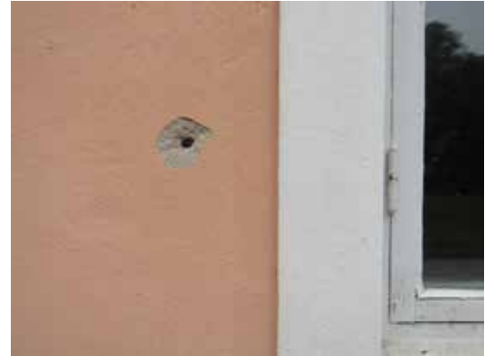
Fasaden är putsad och mot timret finns så kallat spikteglet. På enstaka ställen har spikteglet spikar rostat och sprängs loss bitar av av putsen.
