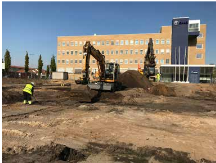
Figur 45. Schaktning av tomt 208 i den mellersta delen. Närmast i bild syns tydligt det sandlager som låg under Hus 1346 och den kompakta torven på dess båda sidor. Foto från öster mot väster.
