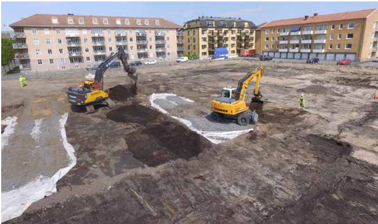
Figur 6. Del av undersökningområdet sett från sydväst. För att kunna köra över redan schaktade ytor med grävmaskin, byggdes körvägar på duk med makadam för att spara lagren. Detta kunde endast göras i toppen av varje ruta.
