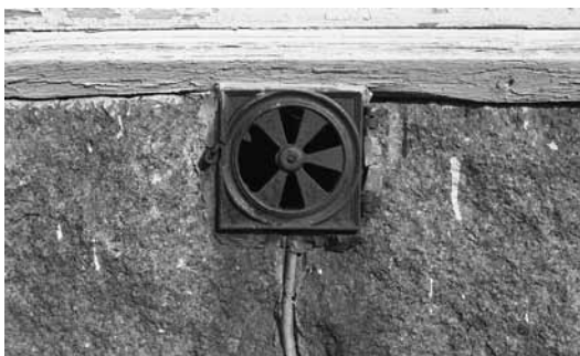
En av de skadade ventilerna och fogen med den ursprungliga utformningen.
