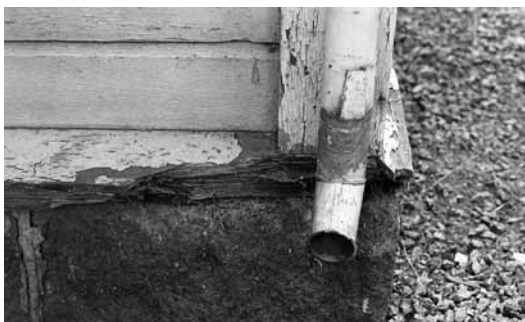
Detalj rötskada på fotbrädan.
