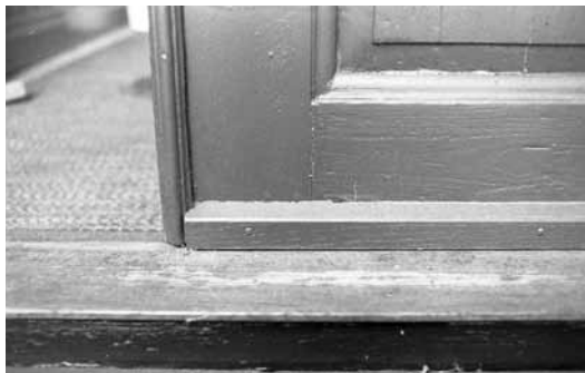
Entrédörren med den nya listen som monterades på högra dörrbladet för att förhindra vatteninträning.
