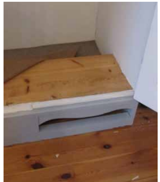
Ventilationen i skåpen var bristfällig vilket lett till mögelangrepp på textilierna. Hål togs upp i golven.
