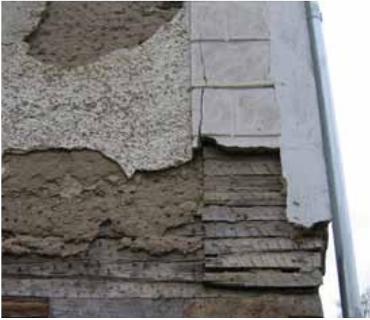
Fasadputsens har en underbyggnad av s k pligg i trä. Hörnkedjorna är dock uppbyggda med liggande eller diagonala ribbor, s k spräckpanel.
