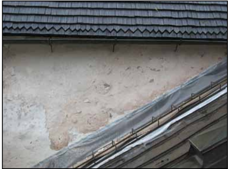
Ett av kyrkofasadernas större sammanhängande partier med äldre kalkputs sitter i vinkeln mellan sakristians och korets takfall.
