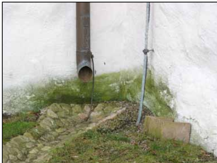
Bristfällig vattenavledning har skadat och missfärgat putsen i hörnet mellan kor och sakristia.
