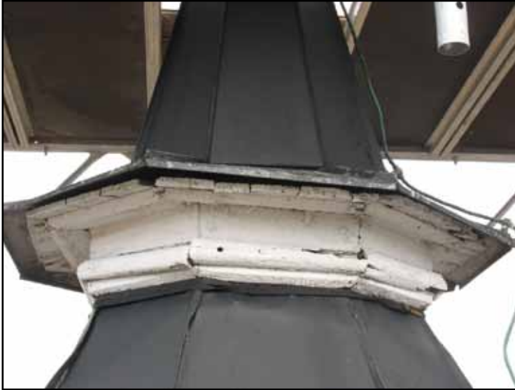
Skadade delar av listen åt söder på den övre av tornspirans två takfötter.
