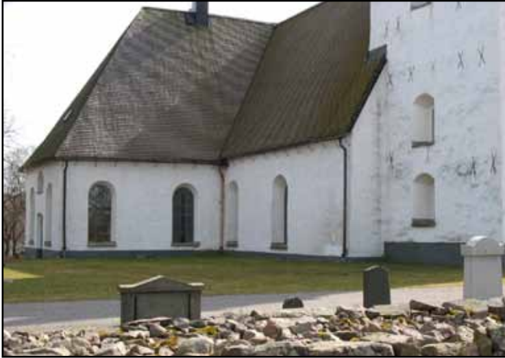
Långhuset och norra korsarmen före restaurering. Till höger hörnet mellan dem båda. Putsskador i anslutning till solbänkar. Fågelbo i stuprörets tratt.
