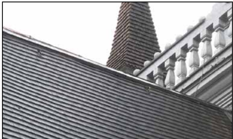
Fästöglor för säkrare arbetsmiljö vid tjärning, monterade undernock på långhusets norra takfall.
