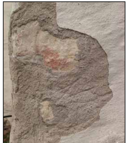
Södra hörnet på korets norra strävpelare. Under KC-putsens tittar en 1600-talsputs fram med spår av dekormåleri i rödbrunt.
