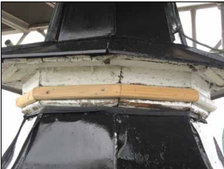
Skadade liststycken på övre takfoten till spiran är utbytta mot nytt hyvlat virke och fäst med smidd spik.
