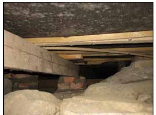
Blick in under korgolvet från trappan till graven. Mögelpåväxt på undersida av sentida trossbotten. Bärninor troligen från restaureringen på 1910-talet.
