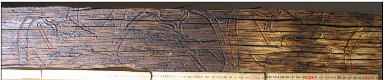
Den dekorristade bjälken fotograferad i släpljus, efter sanering.
