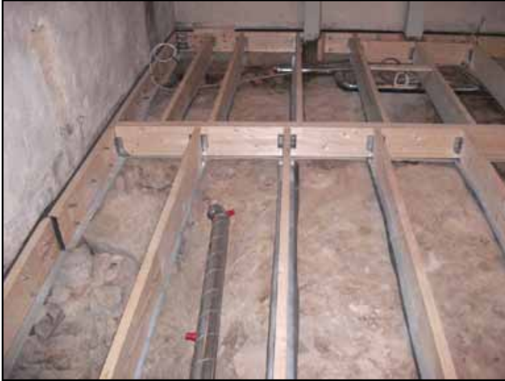
Läget för den kommande sorptionsavfuktaren och fläkten i korets nordöstra hörn under de nya bärlinorna. Foto: Bröderna Bergström.
