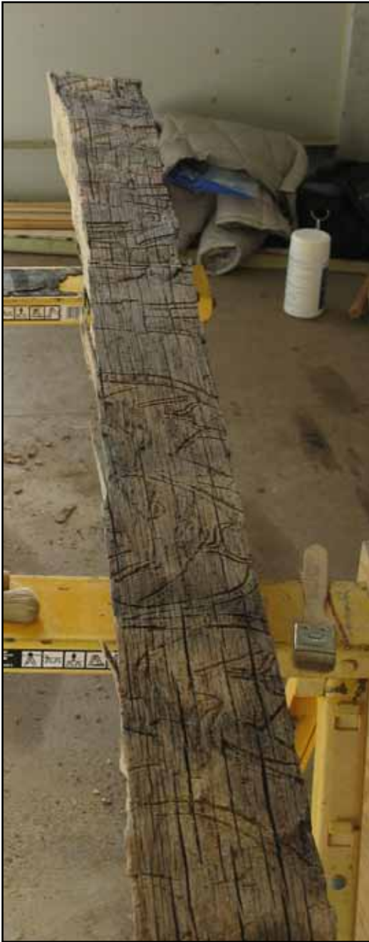
Bjälken under sanering, före tjäran trängde upp på ytan.
