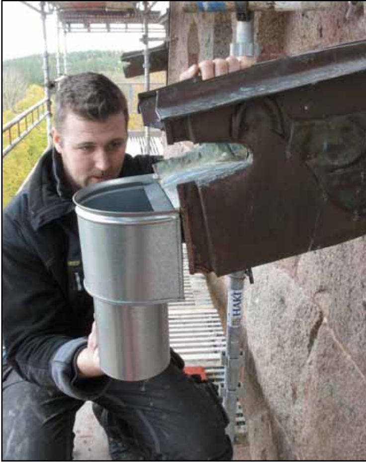
Johan Thelander, Tobias plåtslageri, med prototyp för vattkupa till de nya stuprören på tornet.
