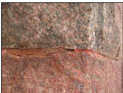
Tunna fogar med cementhaltigt bruk i dåligt skick.
