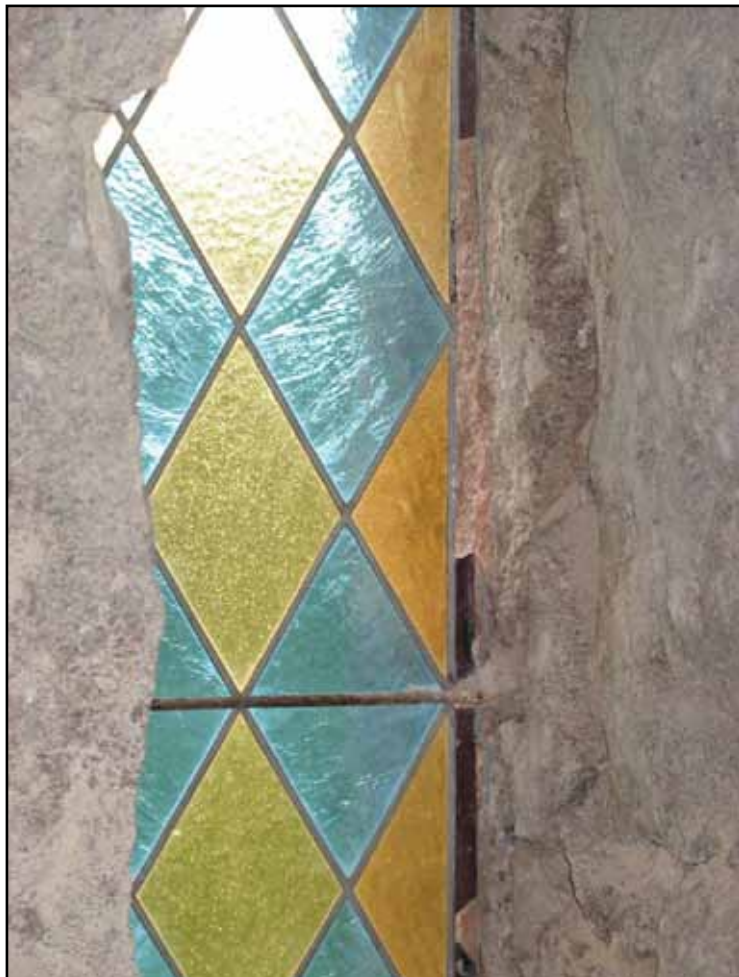
Skadad bård på det sydvästra tornfönstret.
