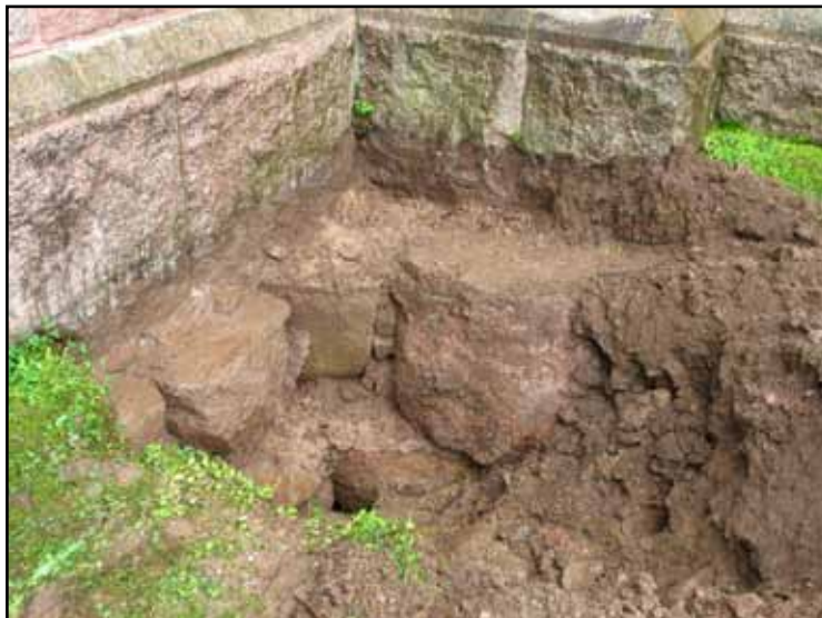
Kyrkans grundläggning, provgröp 2009. Håligheter mellan blocken tillåter vatten att tränga in under kyrkan.
