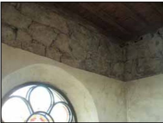
På grund av svampmycel höggs putsen bort även ett stycke ned i den andra tornvåningen.
