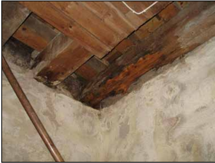
Angrepp av äkta hussvamp på bjälklaget som bär klockorna.
