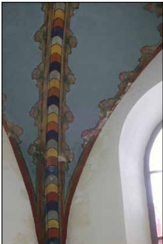
Utfällningar och färgsläpp i absiden.
