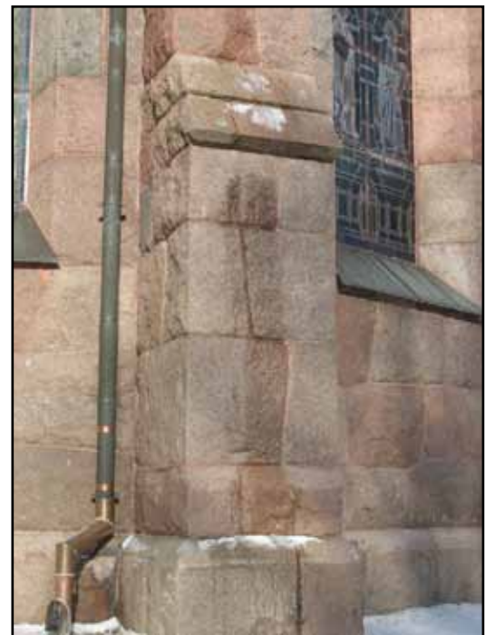
Strävpelare på koret. Smältvatten rinner längs framsidan trots avtäckningens droppnäsa.
