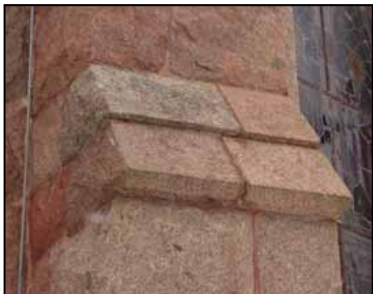
Strävpelarnas avtäckning med vertikala fogar är en källa till vatteninträängning.
