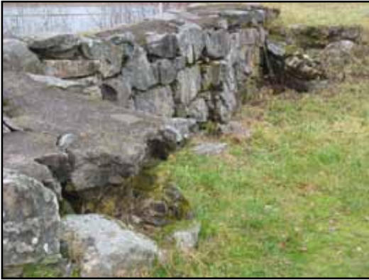
Borghuskällarens nordvästra mur saknar helt murkärna och har varit utsatt för skadegörelse.
