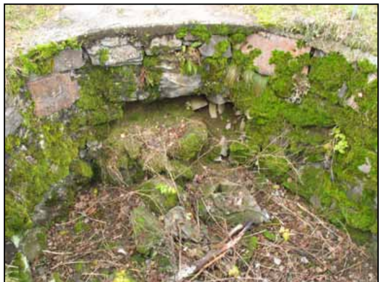
Tornkällarens västra sida. Vatten har troligen runnit längs berget på vilket borgen är byggd och urlakat kalkbruket på denna plats. Cementhaltiga lagningar kan ha bidragit till att stänga in fukt.
