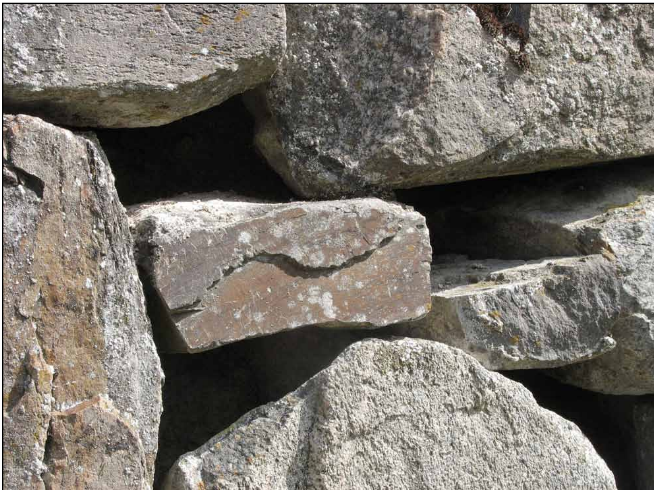
Borghusmurarna sedda från söder. Hörnet vid ingången till vänster i bild har fått en enklare lagning. Det lilla stycket stödmur vid hörnet till höger i bild har återuppmurats.
