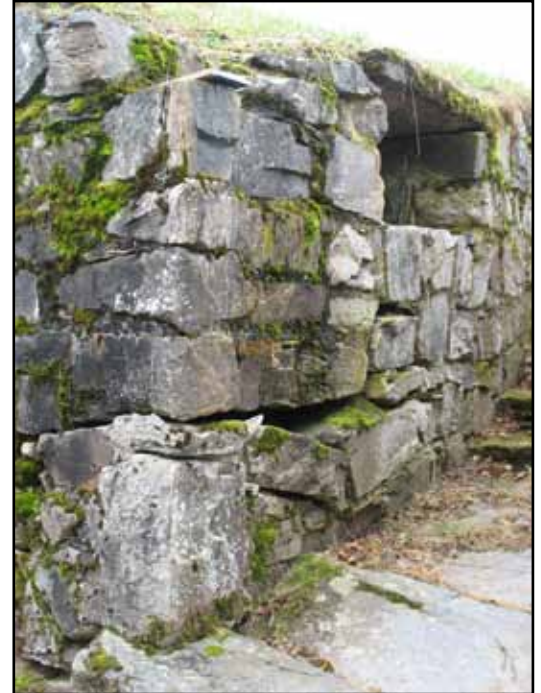
Skadat murverk i lilla trappans vänstra vägg.
