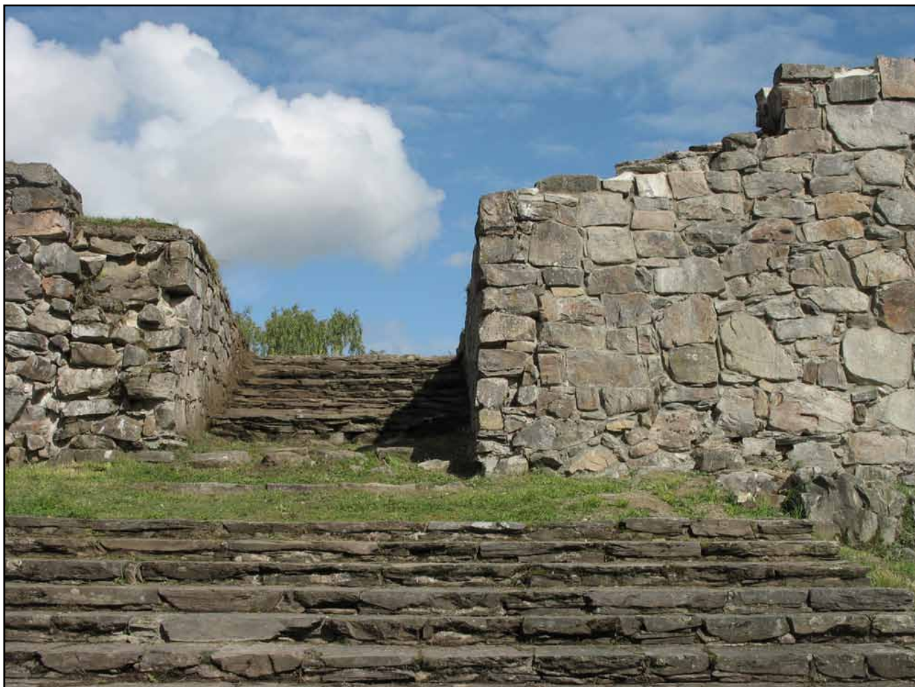
Ingången på sydvästra långsidan. Murbeklädnaden till höger om trappuppgången har tagits ner och återuppmurats samt fått ny bruksavtäckning av cement.
