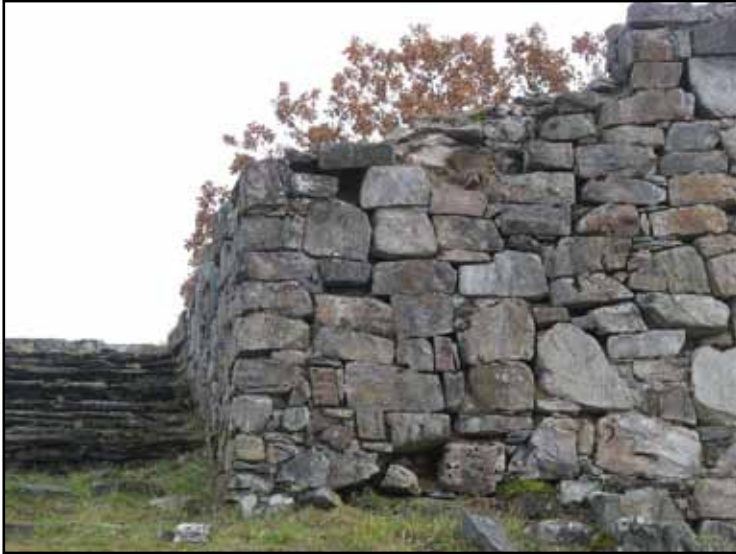
Instabilt fasadparti till höger om stora trappan. Bruket mellan stenarna har brutits ned till sand och avtäckningen är bortvittrad.
