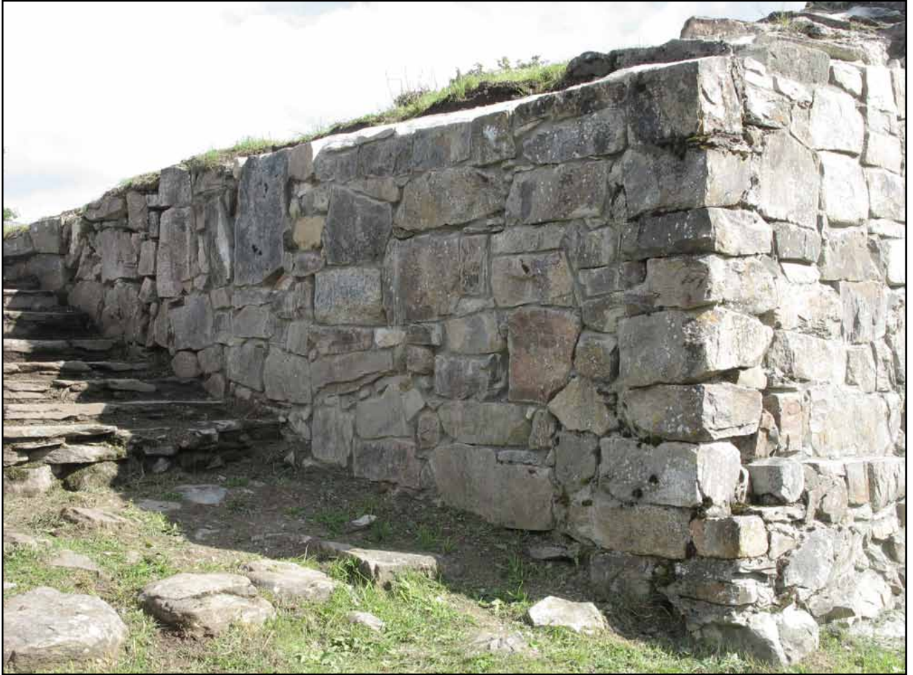
På grund av ras och lösa stenar så fick större delen av murbeklädnaden i trappuppgångens högra sida ommuras.
