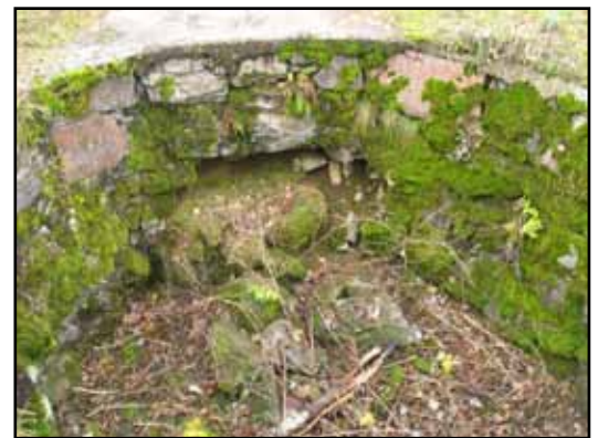
Utfallna stenar i stödmurens ena sida.
