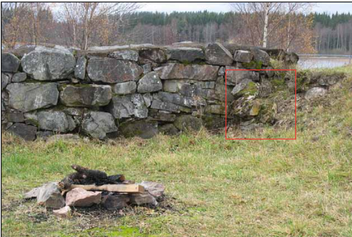
Nordvästra murens insida, norra änden. Nedfallen eller bortbruten sten har hamnat som krans kring en brasa. Mötande stödmur från sydost har kollapsat i ett stycke, markerat med rött.
