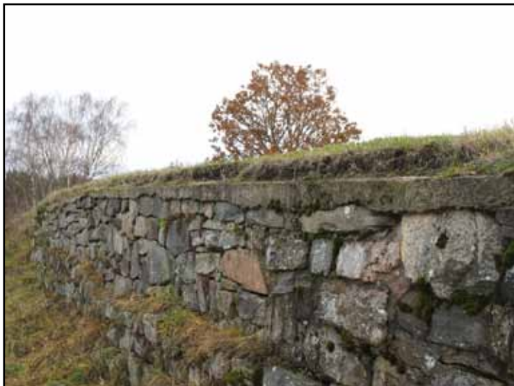
Betongavtäckningens grästorg är borteroderad längs kanterna.
