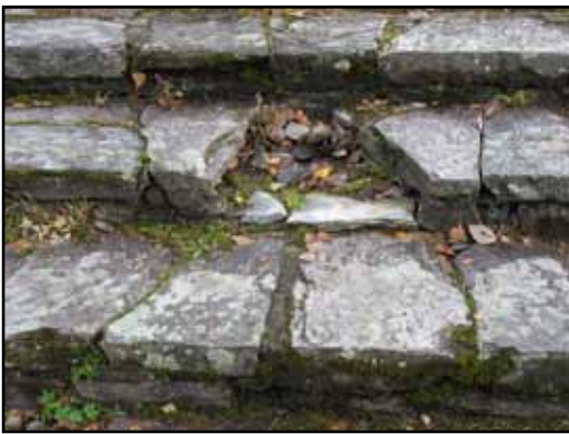
Exempel på skador på skiffertrappan.
