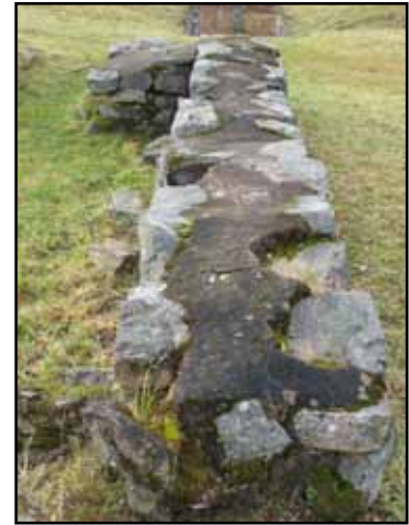
Bristfällig krönvtäckning av cement på nordvästra muren.
