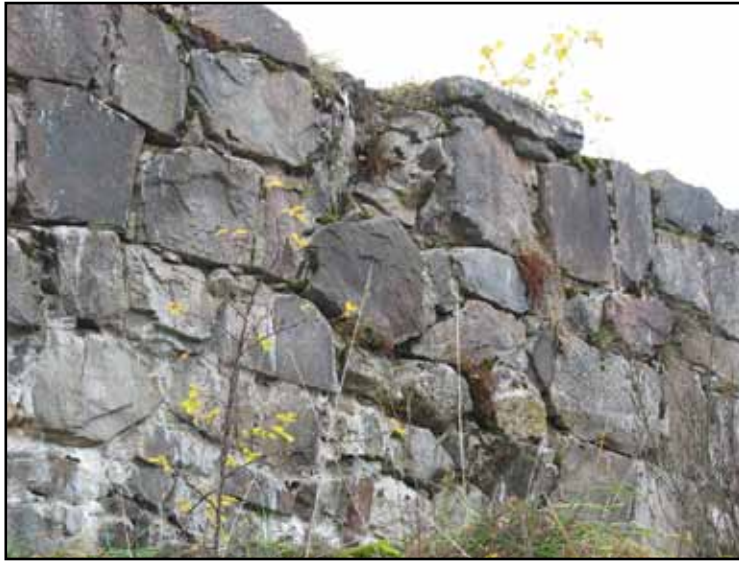
Ovan: bortfallen sten i murkrön. Till höger: hål i cementavjämning ovanpå murkrön.
