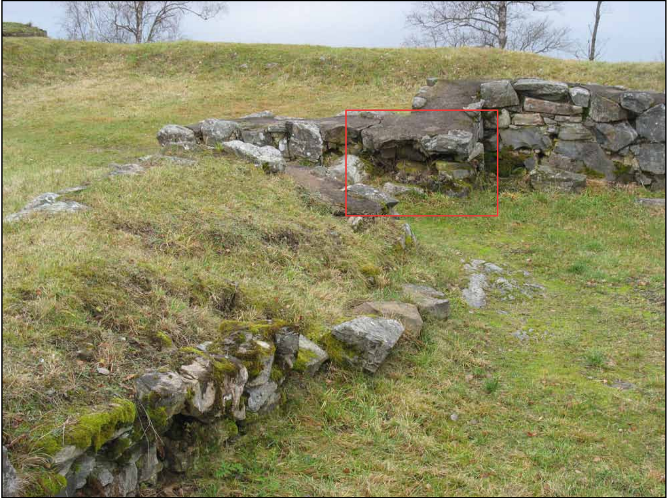
Borghuskällarens sydvästra stödmur i förgrunden med kalvningstendenser, avtäckning saknas. Markerat med rött är ett parti av nordvästra muren med omfattande bortbrytning av sten.
