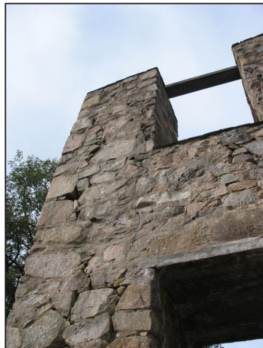
Sprickor och fogsläpp i sydöstra hörnet.
