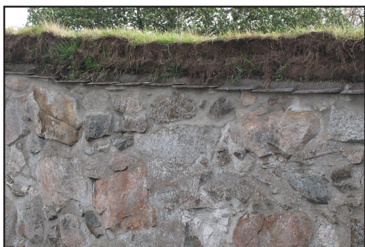
Parti av kökets södra krön som till stor del är omfogat. Hydrauliskt kalkbruk har använts med en pigmentering som tar sin utgångspunkt i det befintliga KC-brukets färg.
