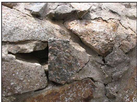
Typiska fogskador. Tidigare restaureringars KC-bruk har släppt från underlaget och lakat ur bakomvarande kalkbruk som pulvriserats med lösa stenar som följd.
