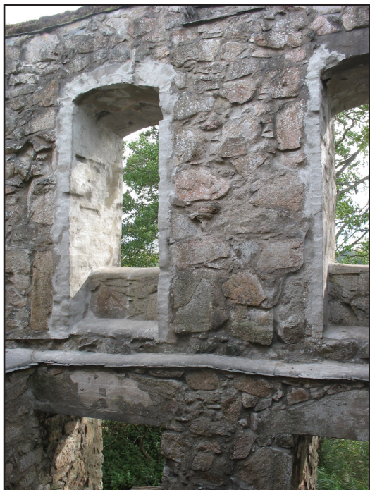
Nyslammade tegelomfattningar kring fönstren i västra kabinetts södra vägg.
