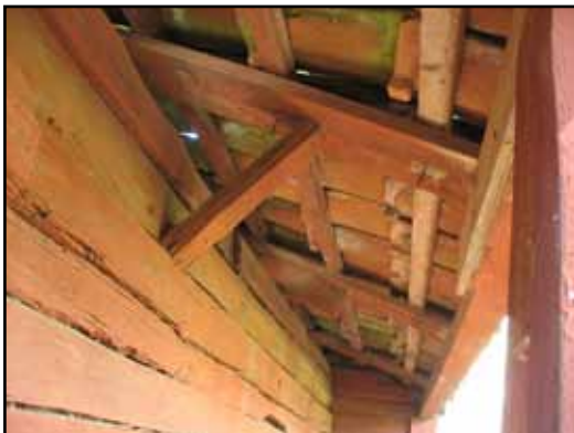
De gamla handslagna lertegelpannorna är omlagda på nya strö- och bärläkt på 1940-talet. En stor del av takfotsbjälkarna är även utbytta då. Exempel från de norra balkarna.
