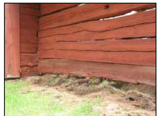
Bortgrävning av jord invid balk i väster. Syllens kraftigt anfränt i underkant.
